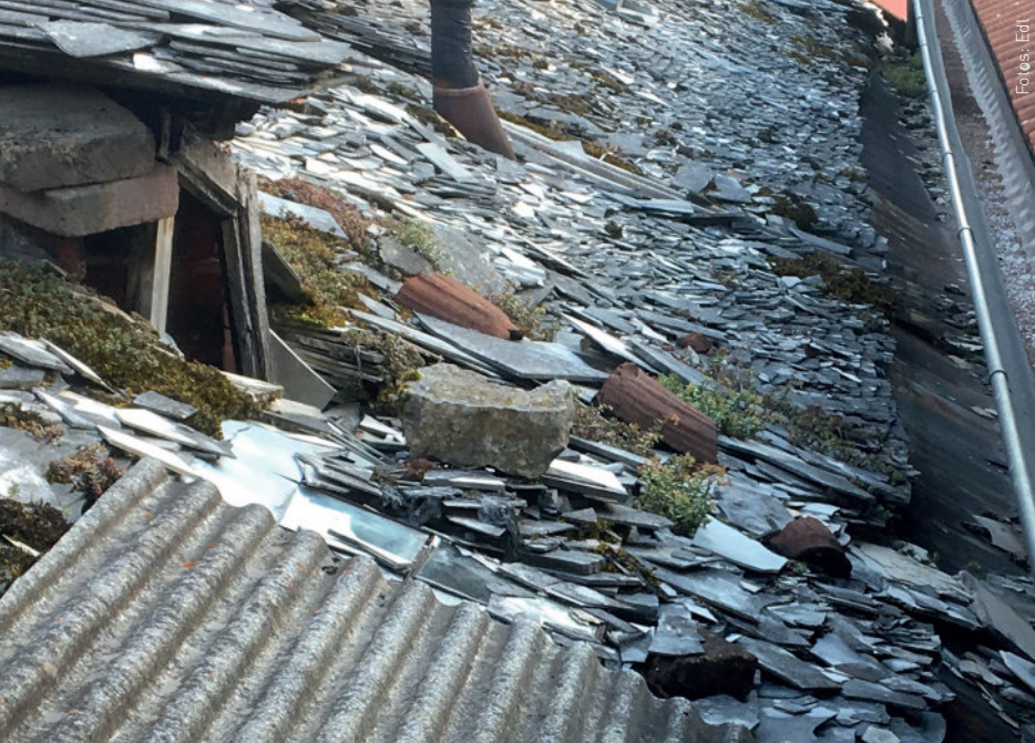
In einem jämmerlichen Zustand war das traditionelle Kalkplattendach vor der Sanierung.
